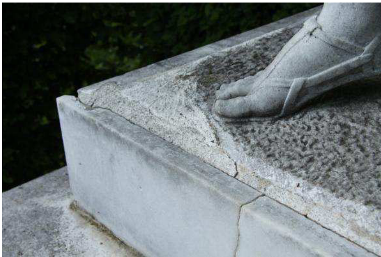
Gerissene und bereits verschobene Plinthenverblendung mit desolater Fuge am Sockel des "Apollon" (Nr. 42).
