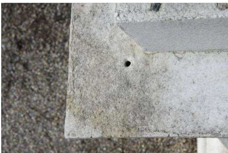
Ein Beispiel der zahlreichen Bohrlöcher an den Draufsichten der Sockelabdeckplatten.
