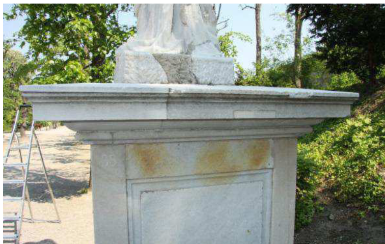
Eisenverfärbungen im Sockel der "Römischen Matrone" (Nr. 38).
